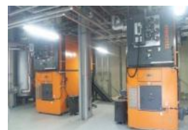
木質バイオマスボイラー
