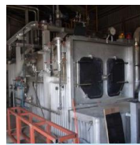
木質バイオマス発電
