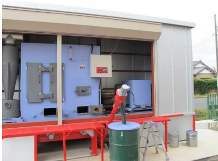
自動灰出し装置と炉内システム
