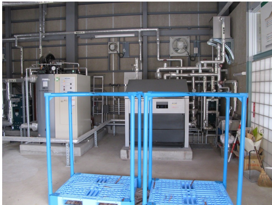
手前 マキラック 左 バックアップボイラー(ガス焚き) 右 マキボイラー本体 約四時間ごとにマキを投入している
