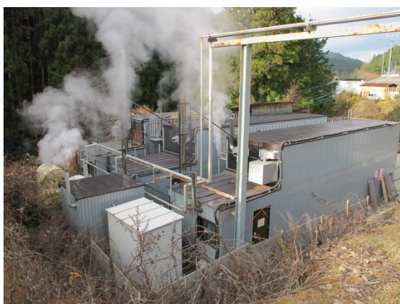
蒸気ボイラーで木材の乾燥に使用している
